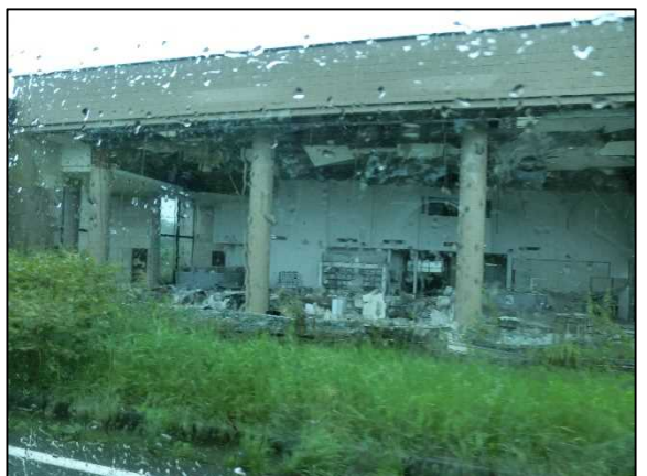
ガラスが割れた自動車販売店
